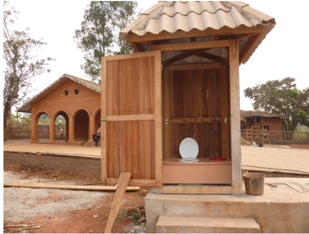
Prototype Toilettes Sèches en phase d'expérimentation sur le Chantier du Centre Médical de Banock
